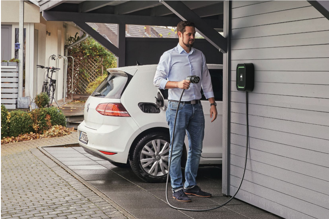
Bild 2: Ladeeinrichtung für Elektrofahrzeuge auf einem privaten Grundstück
