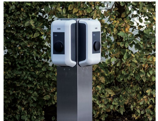
Bild 11: Ladeeinrichtung im Außenbereich
